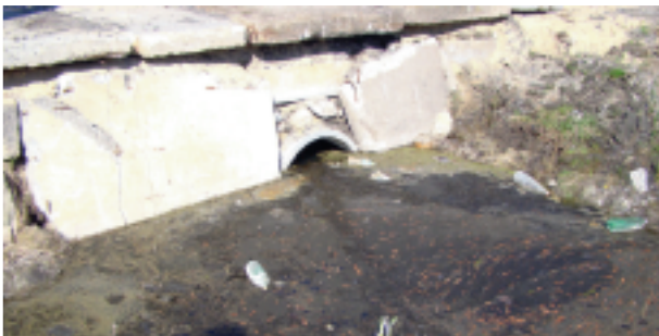
zatory przy przepustach w Wojcieszynie
