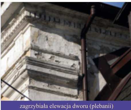
zagrzybiała elewacja dworu (plebanii)
